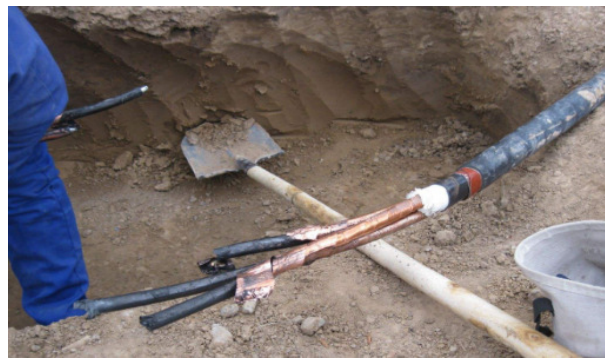
图 8 埋地电缆外破事故现场
