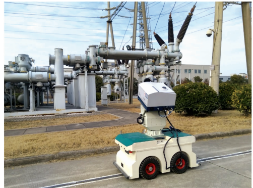
图 3 变电站检测现场, FTIR 光谱仪搭载在 AGV 小车上对变压器进行巡检
