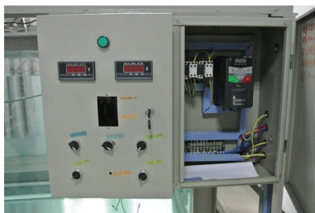
图 10 拖车控制器 Fig.10 Controller of trailer platform
