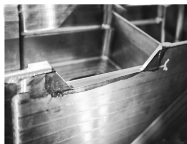
图 2 损伤部位规则化处理
