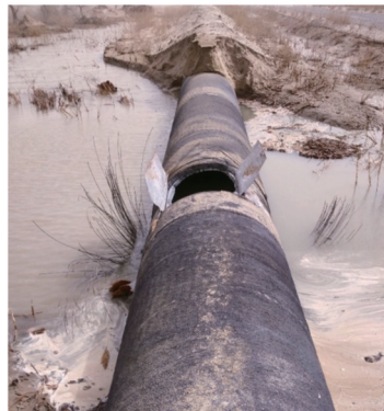
图1 爆管事故现场图 [9]
