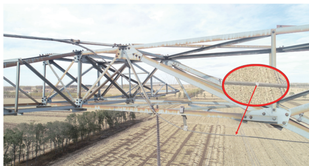
图 11 故障现场图片
