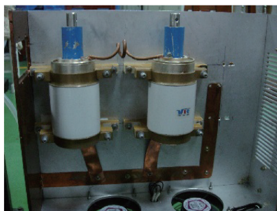
图 11 放电电极板的匹配网络实物图
