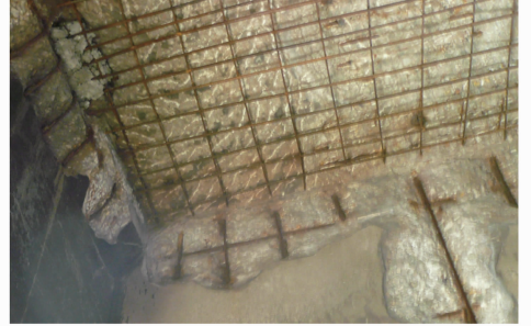
图 1 钢筋混凝土结构的损坏
