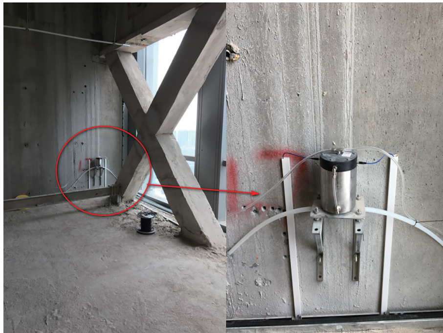
图 11 沉降传感器现场安装效果图
