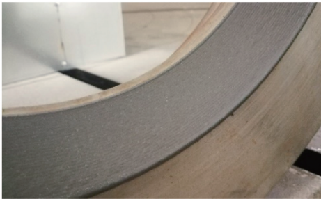
图 20 阀座修复后的表面形貌
